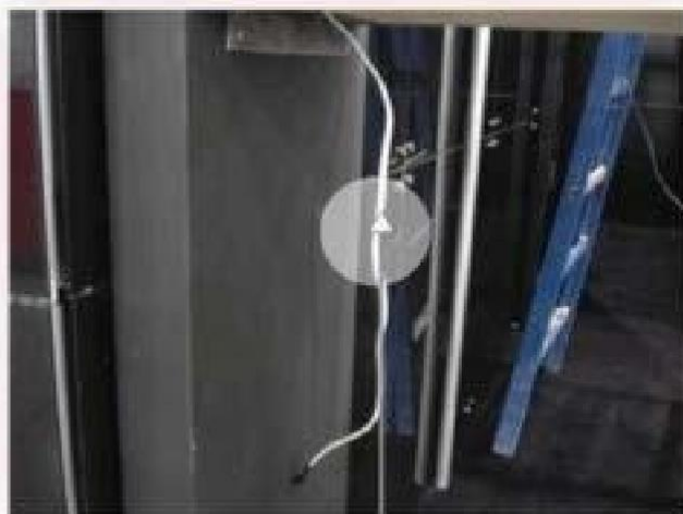
Fio paralelo perigo de incêndio
