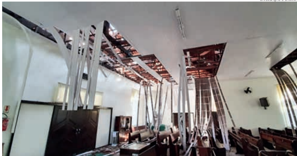
Em Garuva, uma das comunidades mais atingidas, os ventos arrancaram o telhado e destruíram a forração interna das instalações comunitárias.
