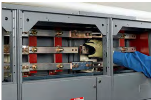
Figura 45 – Deslizamiento del ensamble de empalme hacia a la izquierda
