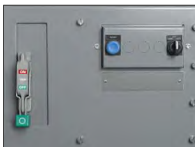
Figura 91 – Seguros de puerta del CCM con contención de arco
