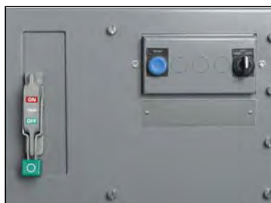
Figure 91 – Verrous de portes de CCM avec classification de confinement d'arc
