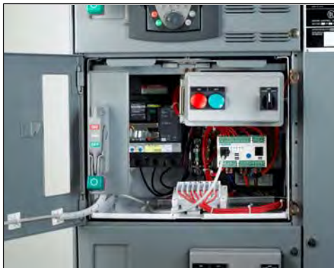
Figura 88 – Unidad de control
