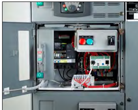
Figure 138 –Manettes alignées avec la face avant du CCM
