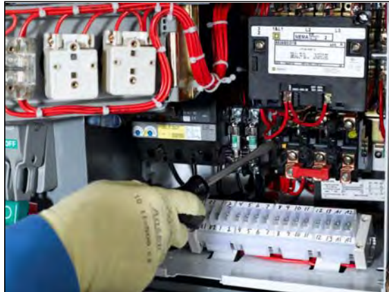
Figura 110 –Disparo del relevador de sobrecarga
