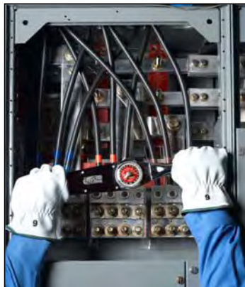
Figura 82 – Compartimiento de zapatas principales (par de apriete de las conexiones)
