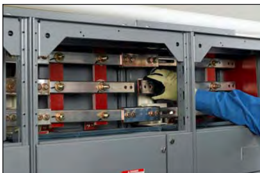
Figure 45 – Glissement de l'ensemble de raccordement vers la gauche
