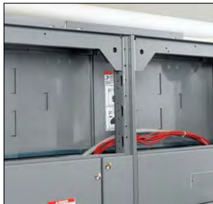
Figure 77 – Câblage dans la goulotte guide-fils horizontale supérieure
