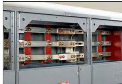
Figura 42 – Cubiertas de la canalización de cables desmontadas y barreras de las barras horizontales abiertas
