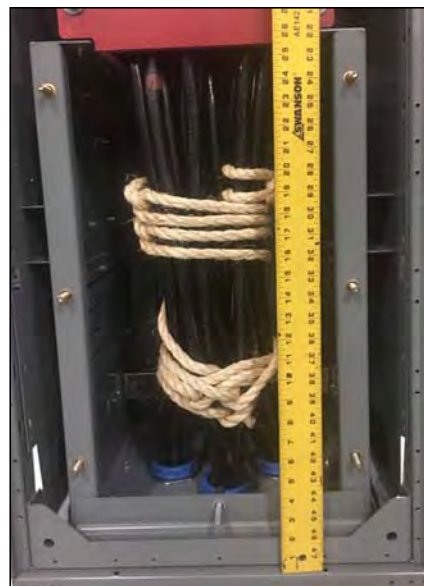
Figure 67 – Groupes de liage de câbles du haut et du bas
