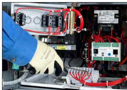
Figura 143 –Conexión de los conductores de control en los bloques de terminales
