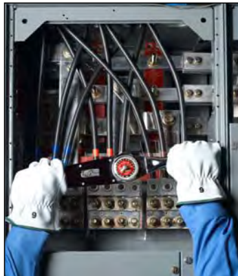
Figura 87 – Compartimiento de zapatas principales (par de apriete de las conexiones)
