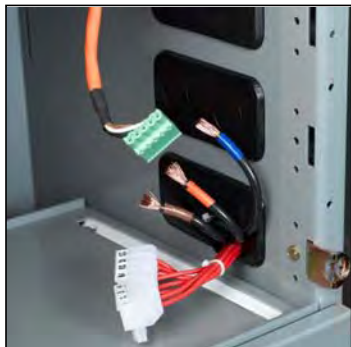
Figura 94 – Conductores de alimentación y parte superior de los bloques de terminales pasados por los agujeros para cables
