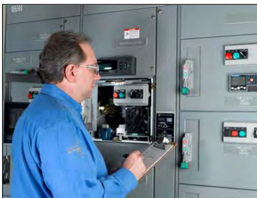
Figura 84 – Verificación de pre-funcionamiento
