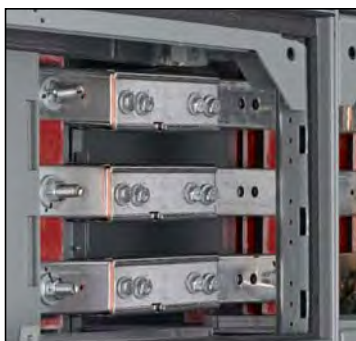
Figura 52 – Cubiertas de la canalización de cables desmontadas y barreras de las barras horizontales abiertas
