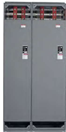
Figura 8C: Con las barreras de dos piezas de las barras desmontadas (conexión de empalme realizada)
