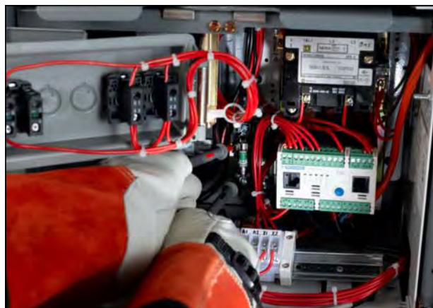
Figure 107 –Inspection des fusibles
