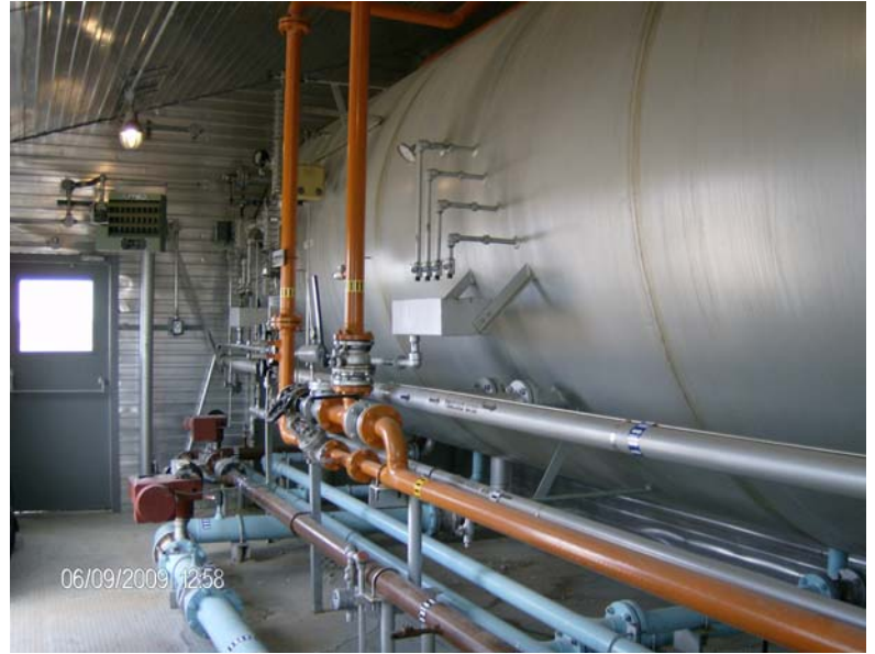
Grand Forks-FWKO_Inside Bldg.
